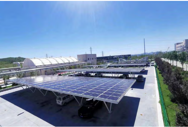
停车场光伏发电项目
