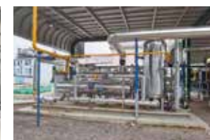
5万吨/年CO 2 捕集试验区项目 增压液化装置
