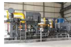
合成氨低温甲醇洗10万吨 食品级CO 2 回收液化项目
