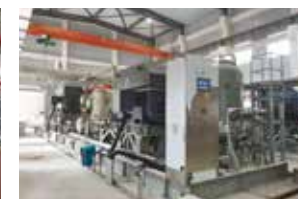
15万吨/年电厂烟气CO 2 捕集 示范工程增压液化装置
