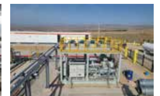
CO 2 驱综合试验站 增压液化装置
