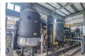
5万吨/年食品级液体CO 2 项目 螺杆二氧化碳压缩机
