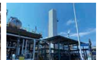
低温甲醇洗排放尾气回收年产 8万吨CO 2 项目增压液化装置
