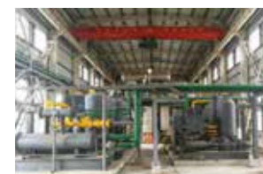
低温甲醇洗10万吨 CO 2 项目 增压液化装置
