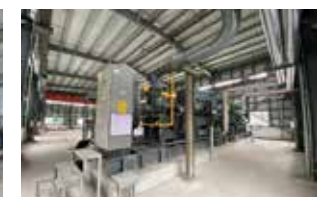
10万吨合成氨尾气综合利用 项目螺杆二氧化碳压缩机
